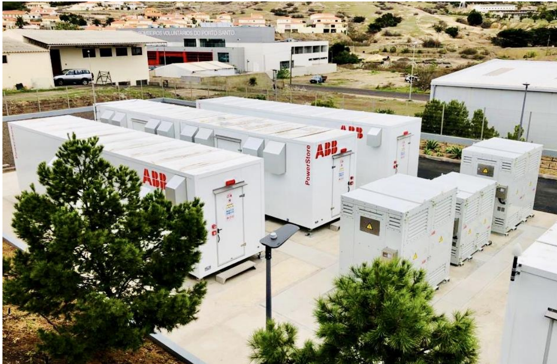
Figura 9: Nova instalação da EEM, denominada como Central de Baterias (CB) da ilha do Porto Santo
